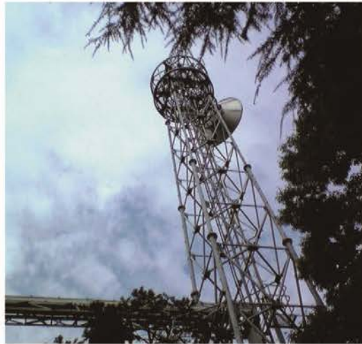
鉄塔とパラボラアンテナ (本部北側)
