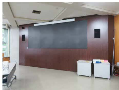
8面マルチモニタ（図書館2F 講義室） SCS (Space Collaboration System)
