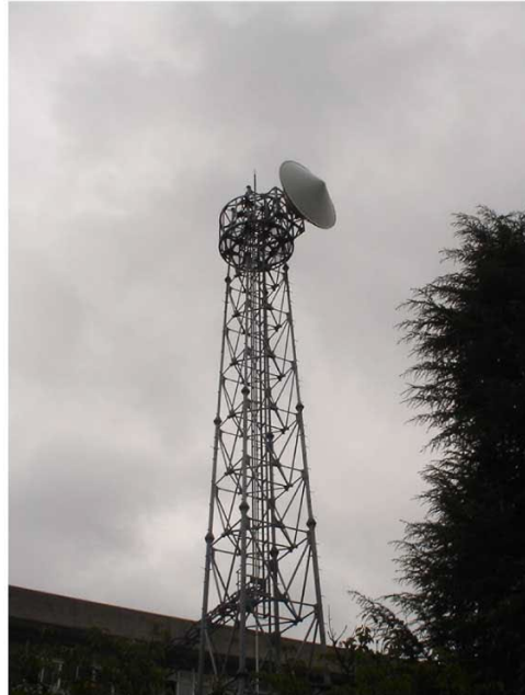
鉄塔とパラボラアンテナ (管理共通棟 素材開発化学科 南側)
