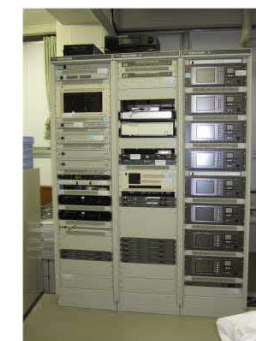
映写機械室 機器
