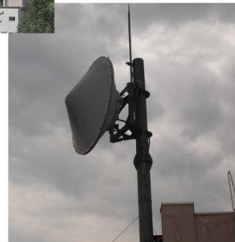
鉄塔とパラボラアンテナ (森林化学科棟屋上 当時)
