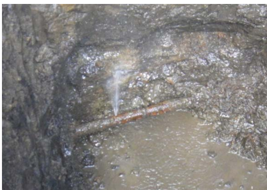
地中埋設給水管漏水状況
