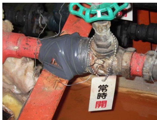
蒸気配管老朽化状況
