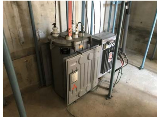
受配電設備老朽化状況 (設置後 40 年以上経過) ※20 年の耐用年数をはるかに超過
