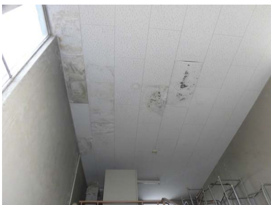
雨漏りによる天井劣化状況
