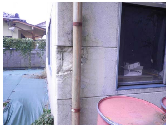
外壁老朽化状況
