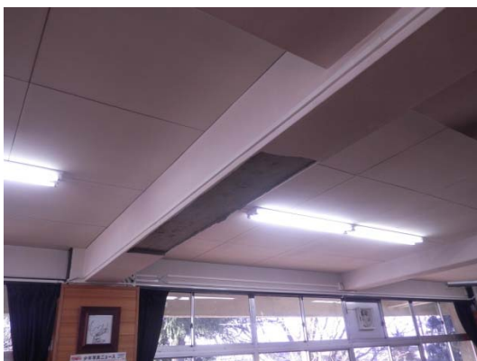
梁モルタル落下状況
