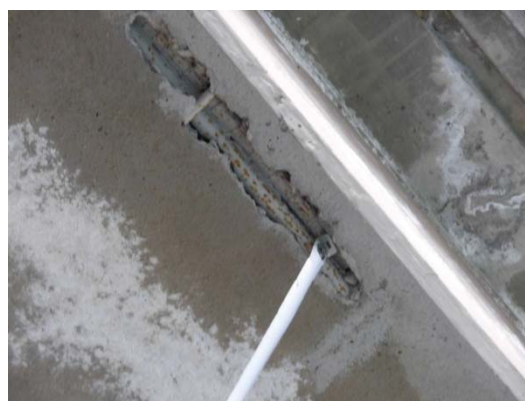
コンクリート片落下状況
