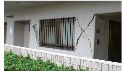
2016年熊本地震におけるマンションの被害調査事例（建築基準法では大地震に対して倒壊や崩壊を防ぐことを目標性能としており、継続使用＝損傷制御までは考慮されない）
