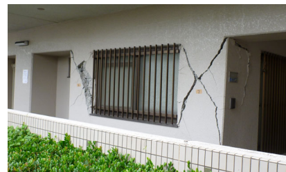
2016年熊本地震におけるマンションの被害調査事例（建築基準法では大地震に対して倒壊や崩壊を防ぐことを目標性能としており、継続使用＝損傷制御までは考慮されない）
