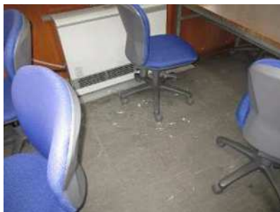
図書館内学生閲覧席横の 窓ガラスの破損
