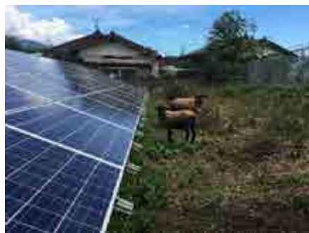
太陽光パネル
