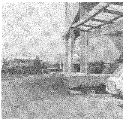
写真2 諏訪警察署敷地の沈下（昭和49年） 車が出入りできるよう、毎年舗装のかさ上げが行われている。
