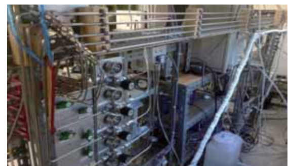
固体酸化物形燃料電池の発電装置
