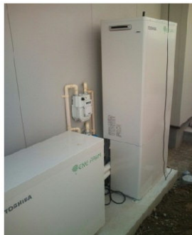
電気とお湯をつくる燃料電池（エネファーム）の外観
