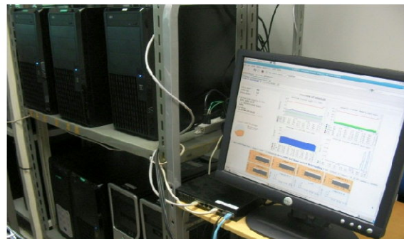
複数台のパソコンをネットワーク接続して一台の高性能なパソコン（PCクラスター）を構築し、コンピュータシミュレーションを実行する
