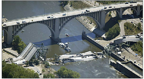
2007年8月1日、アメリカミネソタ州でI-35W橋梁が崩落し、死者13名、負傷者145名の大惨事になった。この橋の橋齢は40歳未満だった
